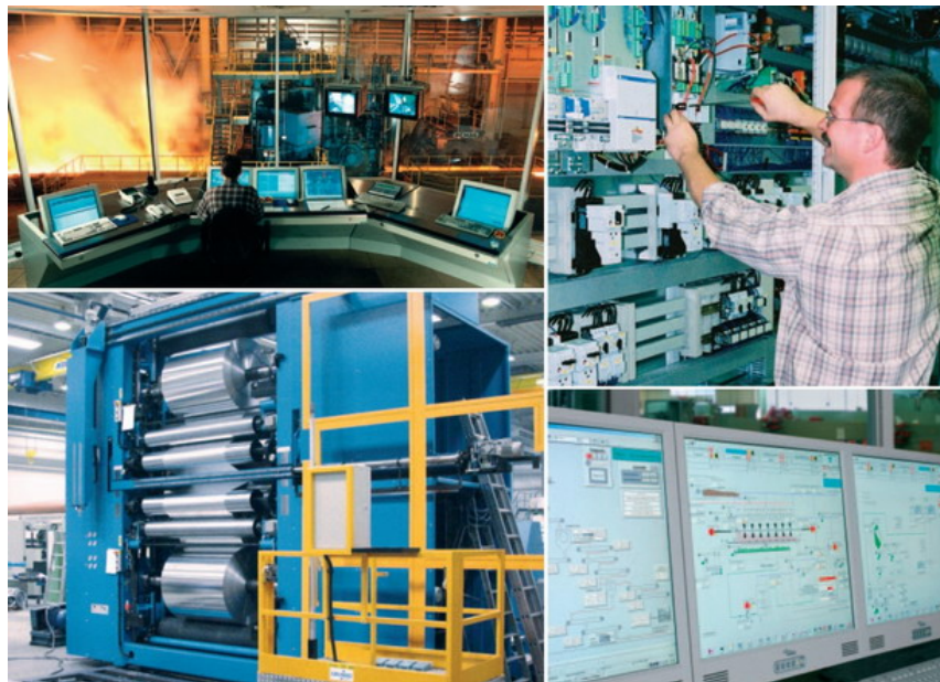
Abbildung 1.1: Automatisierte Anlage der Unitechnik AG [Uni06]
